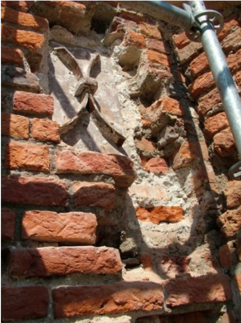
Rzeszów, kościół farny, elewacja północna prezbiterium, odsłonięta metalowa ankra, użyta do wzmocnienia konstrukcji, fot. M. Filip, 2005 r.
