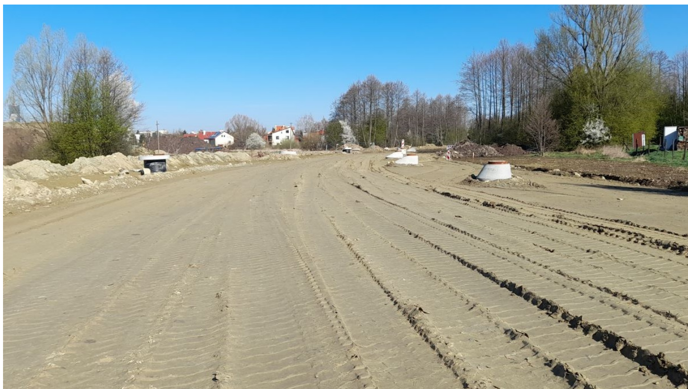
zdjęcie z budowy połączenia al. Krzyżanowskiego z ul. Wieniawskiego w Rzeszowie, fot. Miejski Zarząd Dróg w Rzeszowie
