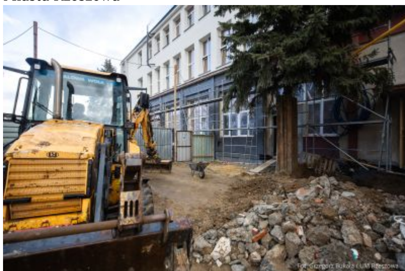
zdjęcie z terenu budowy Zespołu Szkół Elektronicznych w Rzeszowie, fot. Grzegorz Bukała, Urząd Miasta Rzeszowa
