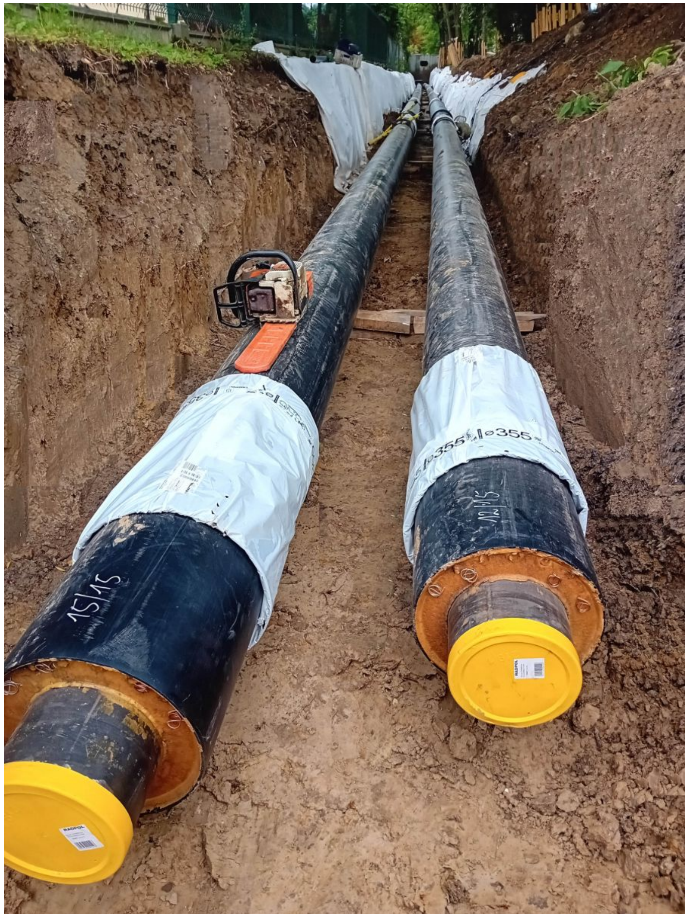
zdjęcie z przebudowy nadziemnej sieci ciepłowniczej przy ulicy Przemysłowej, fot. Miejskie Przedsiębiorstwo Energetyki Ciepłej
