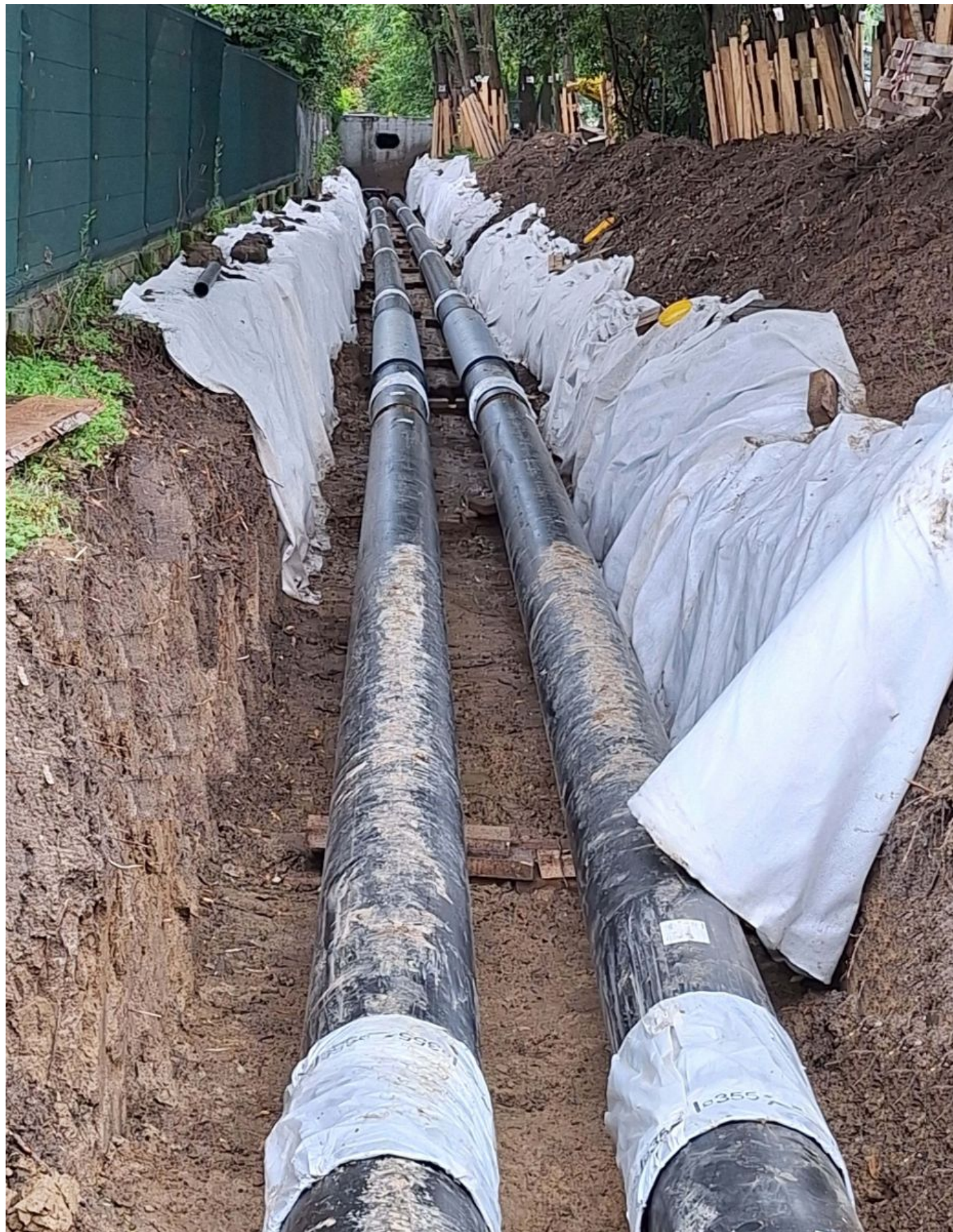
zdjęcie z przebudowy nadziemnej sieci ciepłowniczej przy ulicy Przemysłowej, fot. Miejskie Przedsiębiorstwo Energetyki Ciepłej
